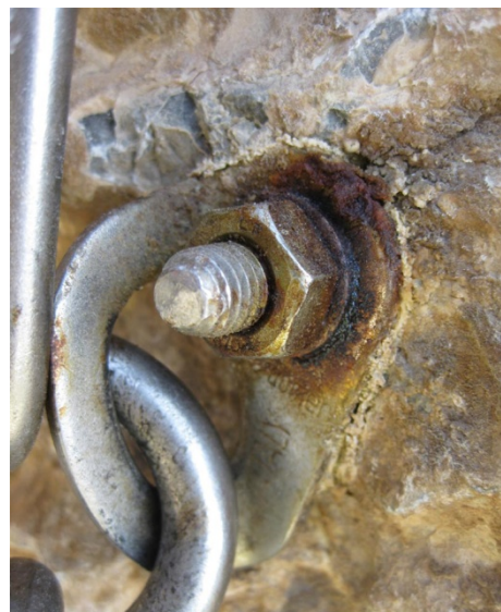
Abb. Korrodierter Bolt in Meeresnähe
